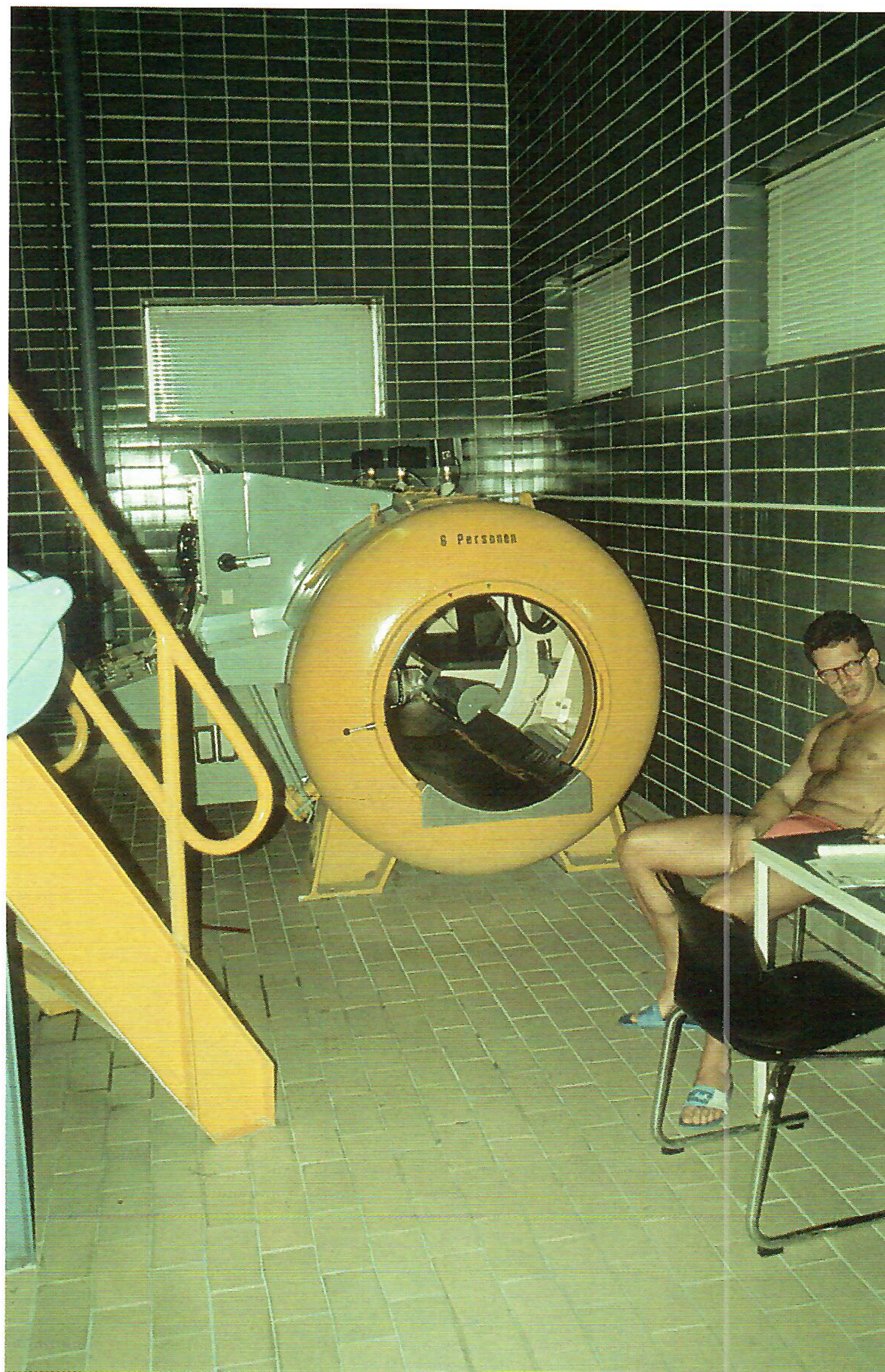
Abb. VI-5/5: Druckkammeranlage am Beckenrand des „Tieftauchtopfes“.
